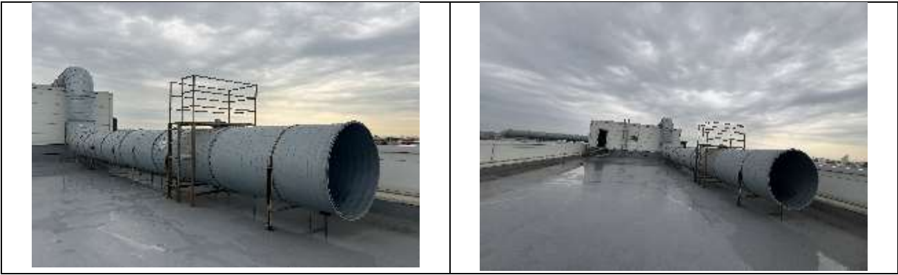
廢氣排放管道及採樣口照片
