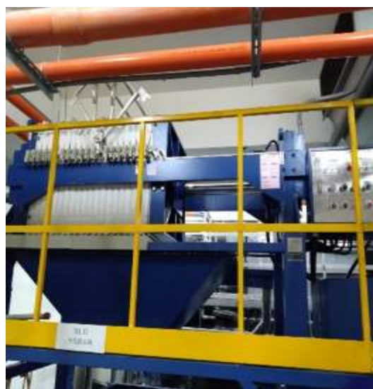
事業廢水處理設備
